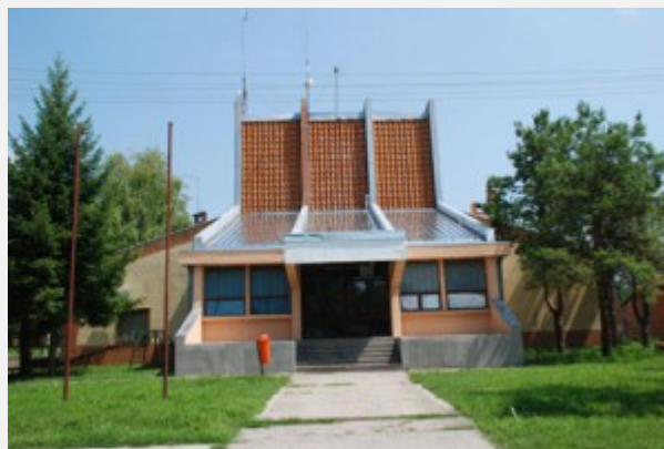
Ivanovački Dom kulture čeka na sanaciju krova
